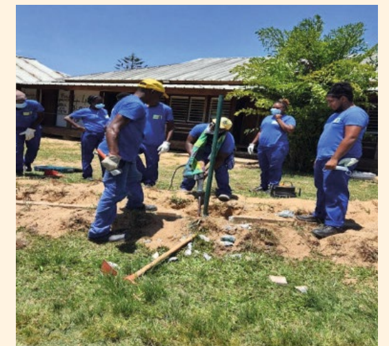
Les jeunes impliqués sur le chantier de la maison de quartier du village Saramaca (ACI)
