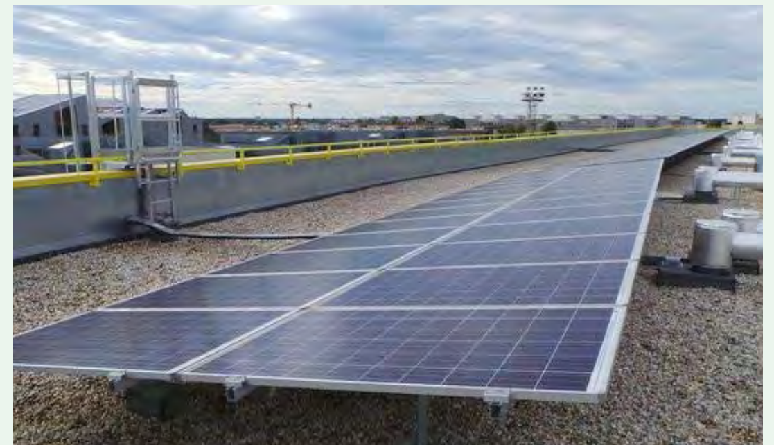
Toiture PV de la résidence Les Souffleurs à Bordeaux – Crédit : Gironde Habitat
